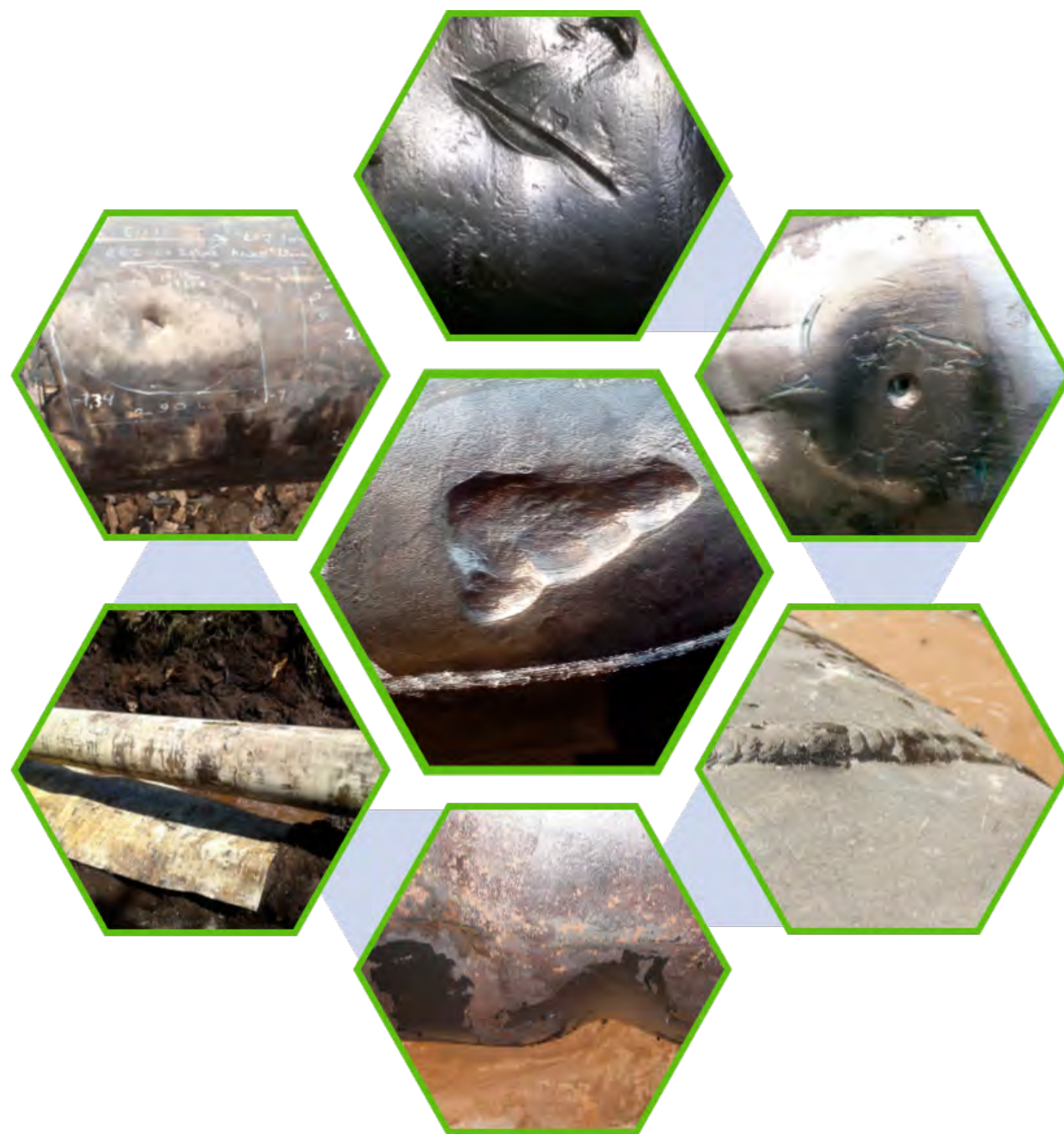
7. attēls. Pārvades sistēmas defektu piemēri
